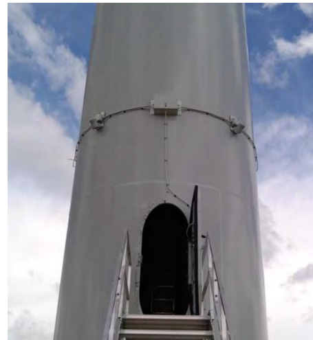
Photographie 15 : Exemple d'installation d'un système sur le mât d'une éolienne. Source : Biodiv-Wind.
